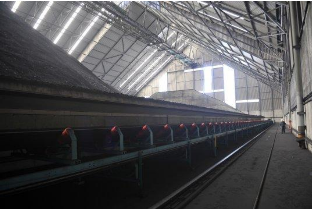
Склад вместимостью 210 тыс. т поделен на три отсека, которые позволяют одновременно хранить уголь трёх разных марок и накапливать три судовые партии. Длина склада – 300 м, ширина – 80 м.
